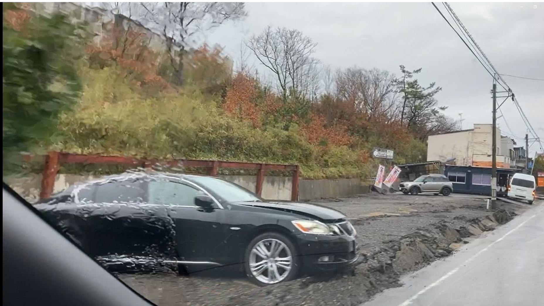
擁壁の傾きと駐車場の膨れ上がり
