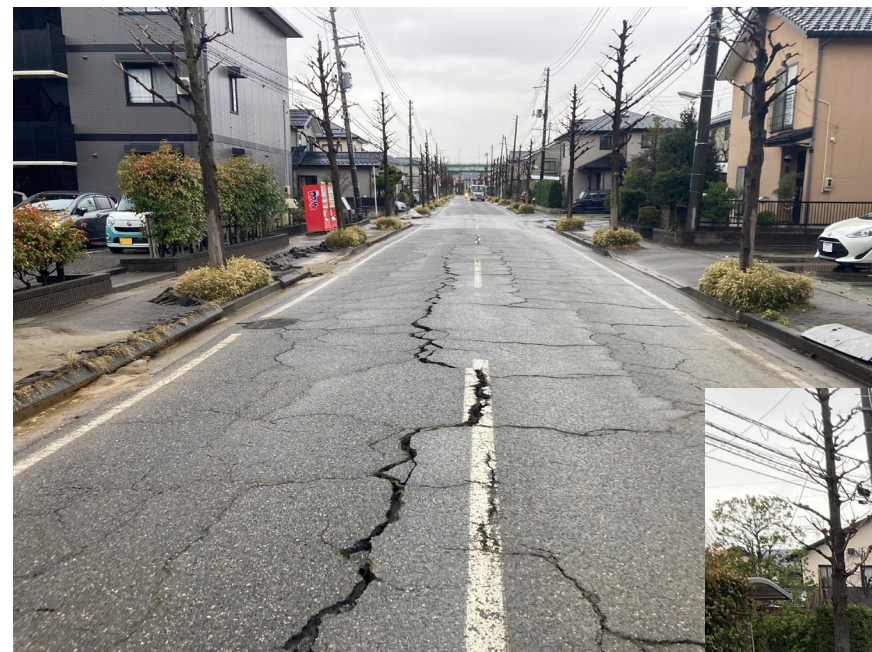
道路面に発生した亀裂と 歩道ブロックのめくれ上がり
