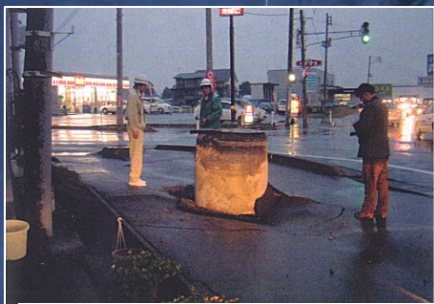
「液状化」浮き上がったマンホール 2)
