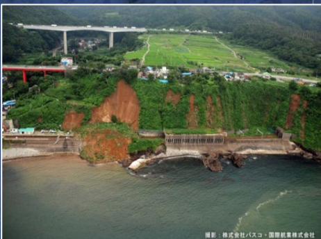
海岸沿いの崖の崩壊による越後線の埋没 (株)パスコ・国際航業(株)
