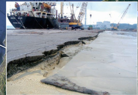
液状化により段差が発生(七尾港 太田地区)
