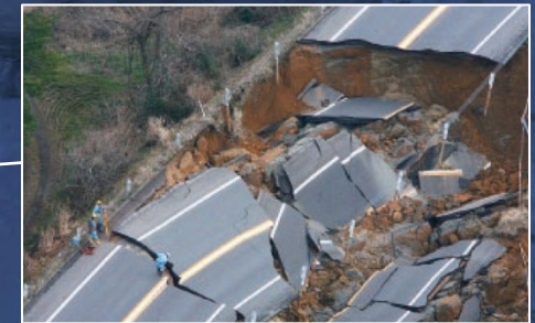
能登有料道路は至る所で崩落(七尾市中島町)
