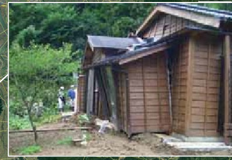
液状化による家屋の傾斜(刈羽村稲場) (新潟県土木部被害状況第5報による)
