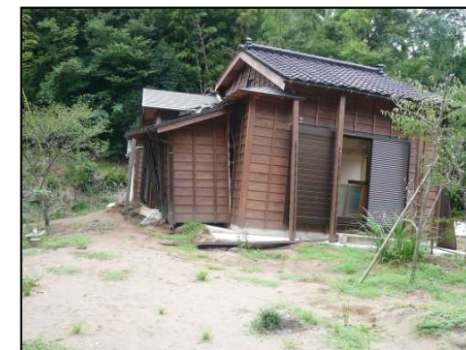
中越沖地震 液状化により傾いた家屋
